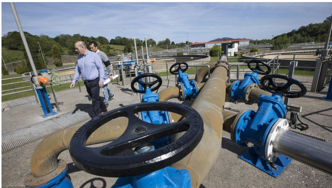
Instalaciones de la depuradora de Villapérez, en Oviedo. / MIKI LOPEZ
